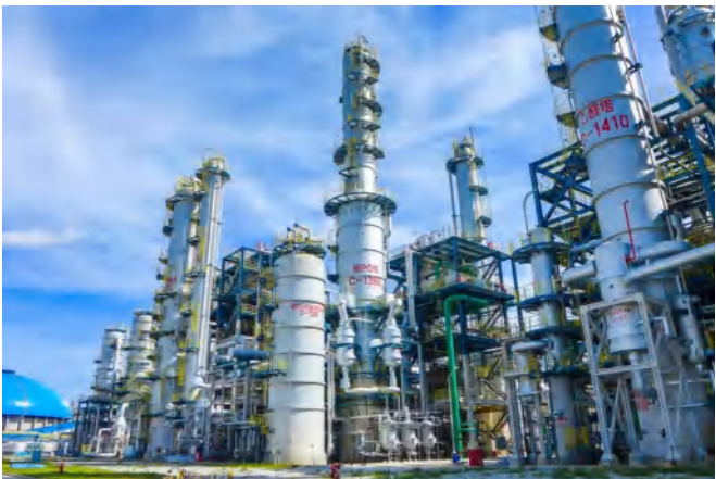
泉州石化精馏系统
