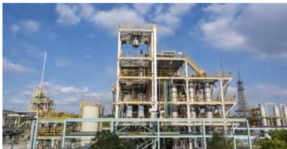
高沸物综合利用装置
